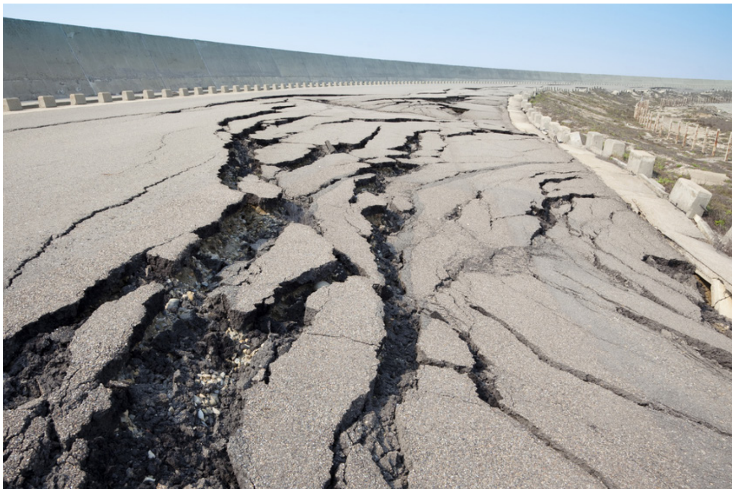
weg vernield door grondverschuiving
